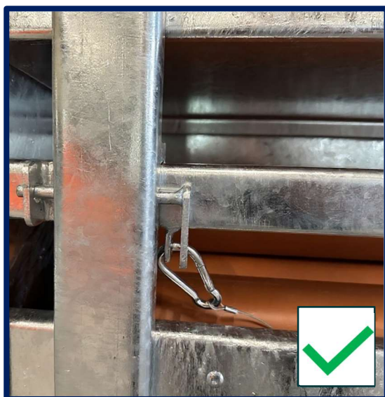
Korrekt sikring med lås
